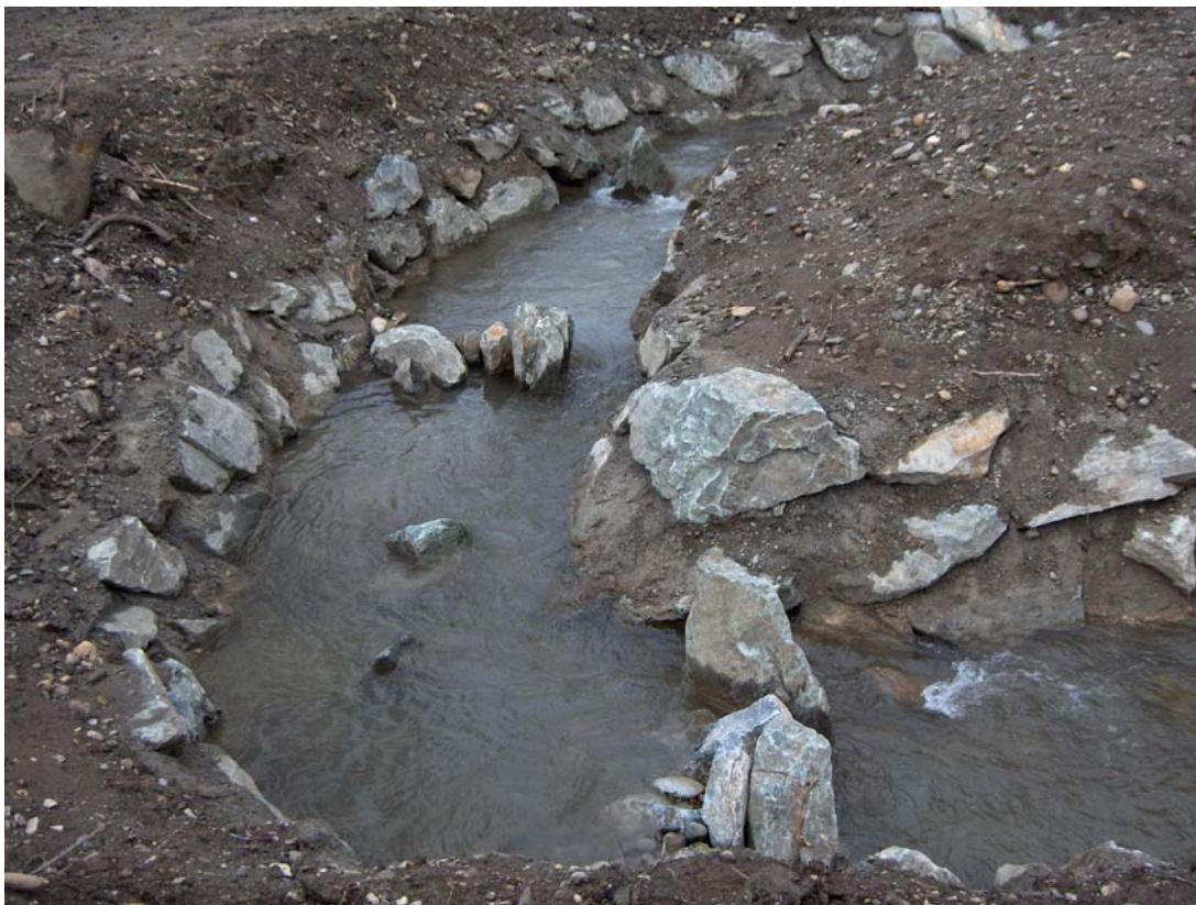
Abb.10: Fischaufstiegshilfe beim KW Rain (Gurk)
