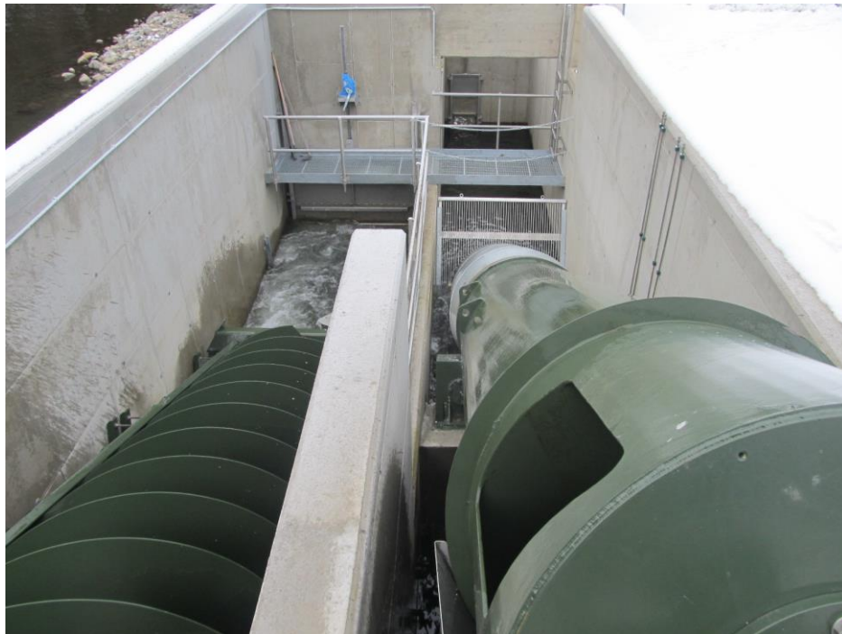
Abb. 4: Fischaufstiegsschnecke (rechts) und Wasserkraftschnecke (links) an der Lavant bei Wolfsberg
