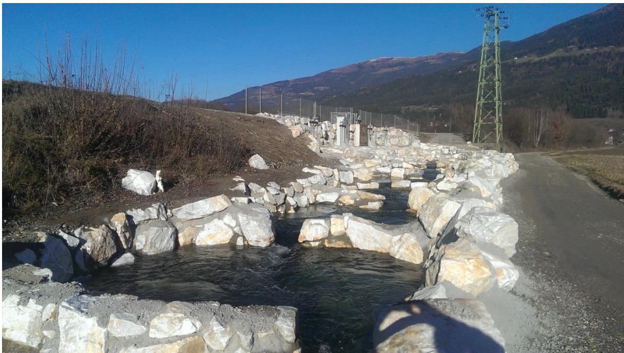
Abb.3: Fischaufstiegshilfe beim KW Kellerberg an der Drau
