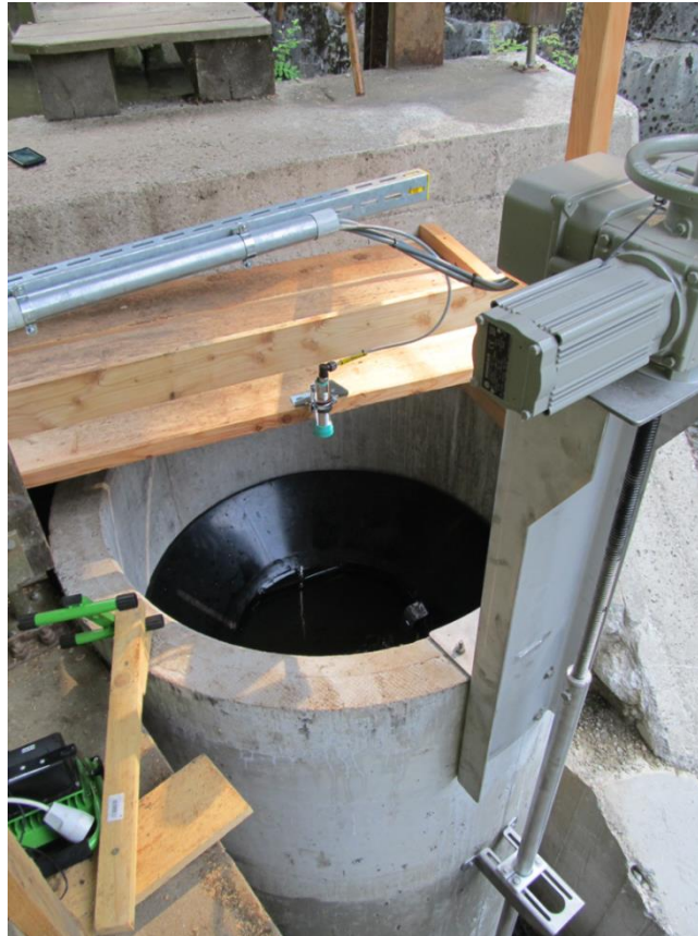
Abb.7: Fischliftschleuse am Löllingbach
